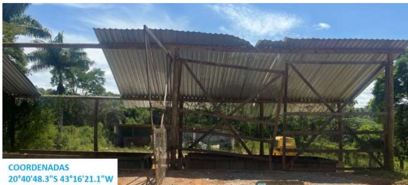
Foto 1 - Usina – local de instalação dos contêineres para acondicionamento temporário de resíduos sólidos, até a coleta e envio a destinação final.
