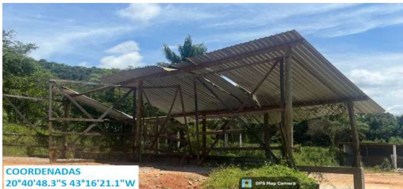
Foto 4 - Usina – local de instalação dos contêineres para acondicionamento temporário de resíduos sólidos, até a coleta e envio a destinação final.
