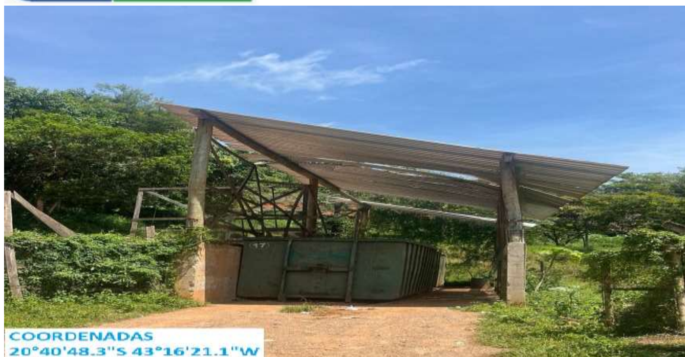
Foto 3 - Usina – local de instalação dos contêineres para acondicionamento temporário de resíduos sólidos, até a coleta e envio a destinação final.
