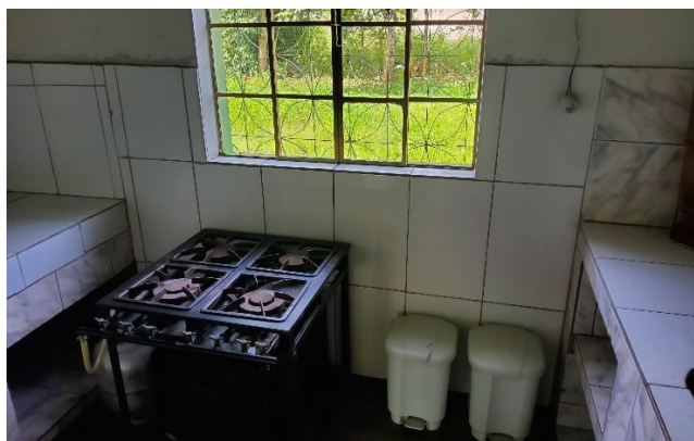
Foto 08: Revestimento Cerâmico a ser demolido
